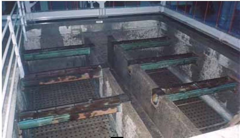
写真：急速ろ過池
